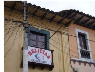
Elementos discordantes: cableado y cartelería
