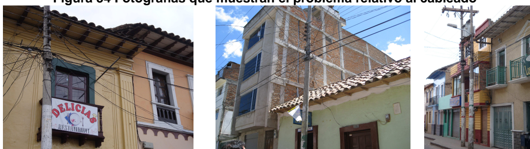
Figura 54 Fotografías que muestran el problema relativo al cableado
