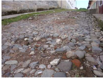
Firme con defectos
