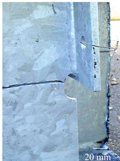
Figura 2.6. Ejemplo de grieta en el fondo de una entalla realizada para eliminar la zona afectada por el calor de la parte inferior de la soldadura del perfil (Imagen proporcionada por Arcelor-Mittal [27]).
