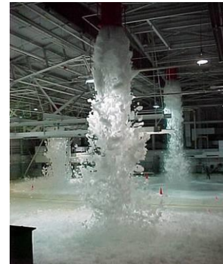
Inundación de hangares
