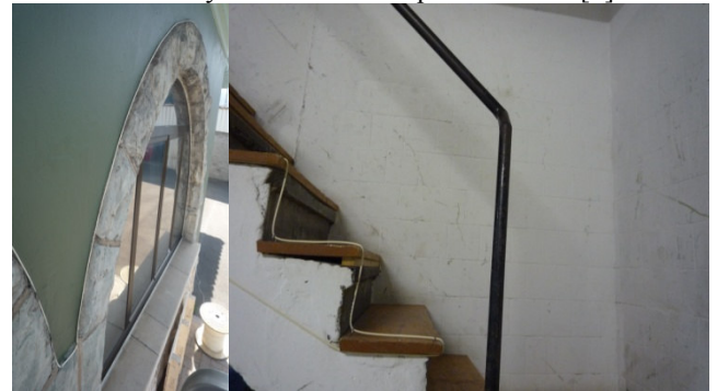
Fig. 3. De izquierda a derecha: tramos de acometida exterior e interior respectivamente.
