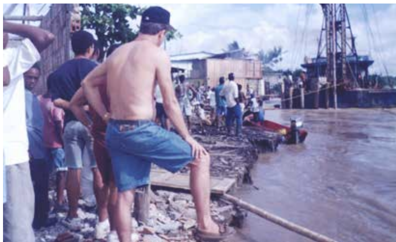
Fotografía 29, dragando el malecón por efectos del canal Naranjo, Satinga.
