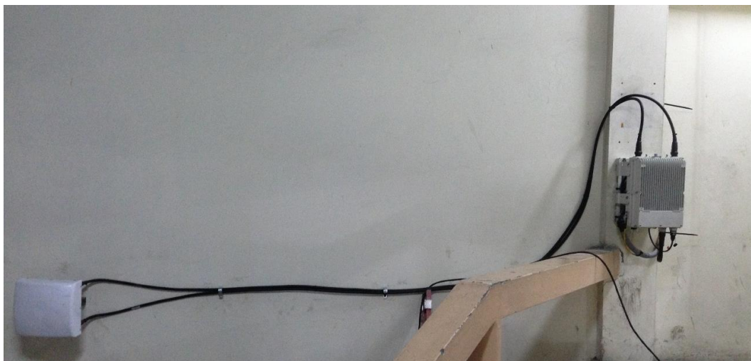
Figura 42: Instalación completa de la Small Cell
