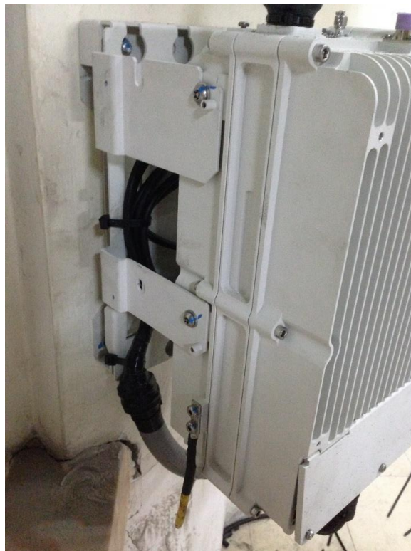
Figura 37: Small Cell conectada a tierra
