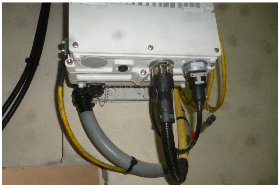
Figura 40: Conexiones completas en la Small Cell (cubre cableado cerrado)
