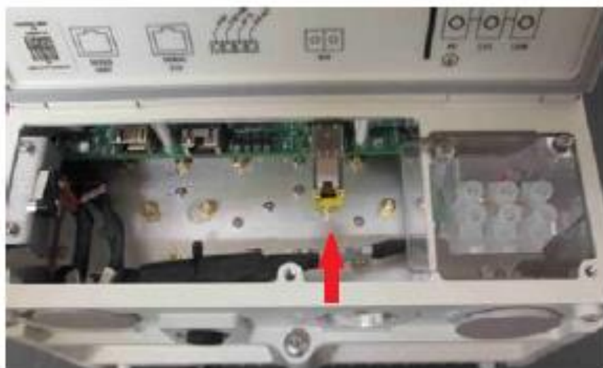
Figura 38: Conexión de fibra a la Small Cell
