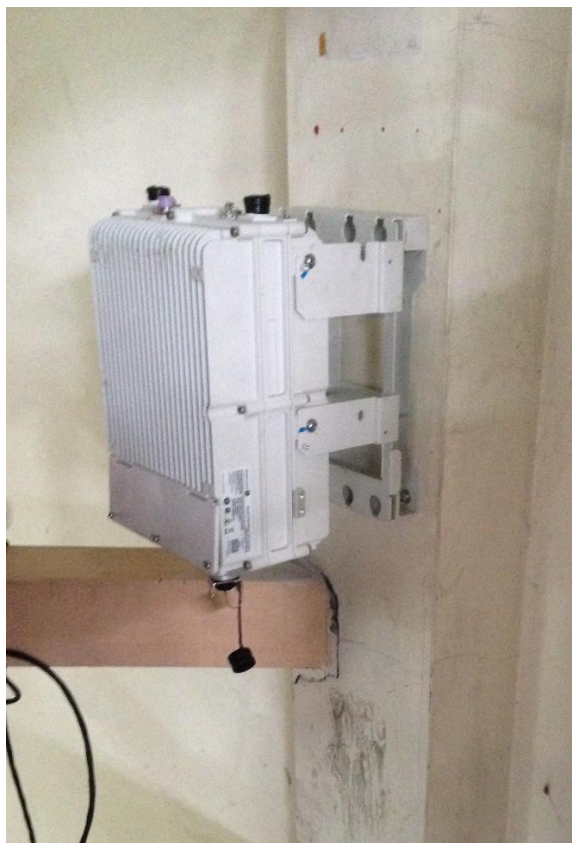
Figura 25: Instalación de la Small Cell en el soporte en la pared
