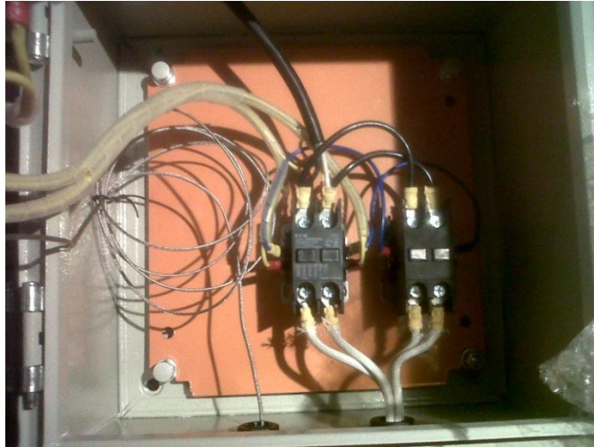
Figura 3.12. Parte interna de la caja de control, contactores + cable de termocupla (gris)
