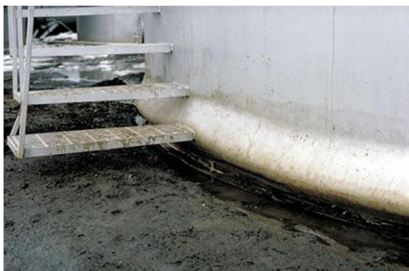
Figura 1.5 Pandeo de las paredes tipo “pata de elefante” producido por el terremoto de magnitud 9.2 de Anchorage, Alaska. Fuente (6).
