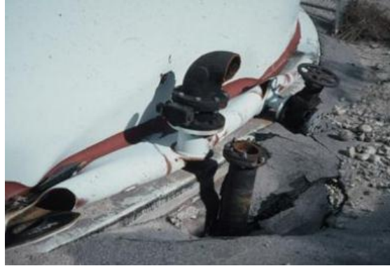
Figura 1.8 Daño en la conexión de tuberías debido al pandeo de las paredes. Fuente (5).
