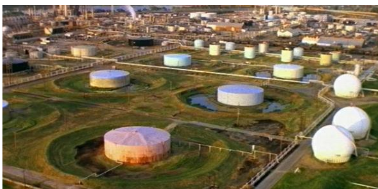
Figura 1.3 Tanques cilíndricos de techo flotante y tanque esféricos para almacenamiento de gas. Fuente (3)
