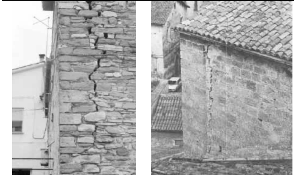
Fig. 2.5 – Danneggiamenti dovuti a scarso ammorsamento tra le pareti.
