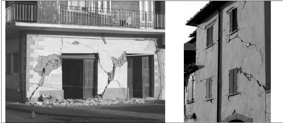
Fig. 2.13 – Danneggiamenti dovuti a crisi per taglio dei pannelli
