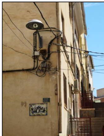
FOTO 3. Abarán. Detalle del tendido eléctrico.
