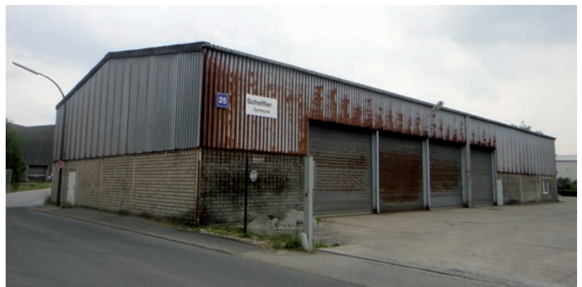
Würde man diese Halle mit Solarthermie-Elementen zusätzlich sanieren, könnte der Betreiber sogar Energie gewinnen.
