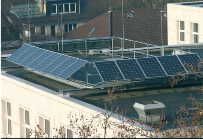
Die Modulstränge auf dem FH-Dach sind bewusst nicht nur nach Süden ausgerichtet. Hier geht es nicht um die optimalen, sondern auch um realitätsnahe, problematische Bedingungen.
