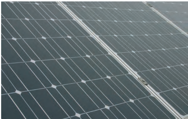
Ist die Energieausbeute zu gering, können auch Fehler in der Kristallstruktur der einzelnen Zellen die Ursache sein. Outdoor-Messstand für Forschung und Lehre.
