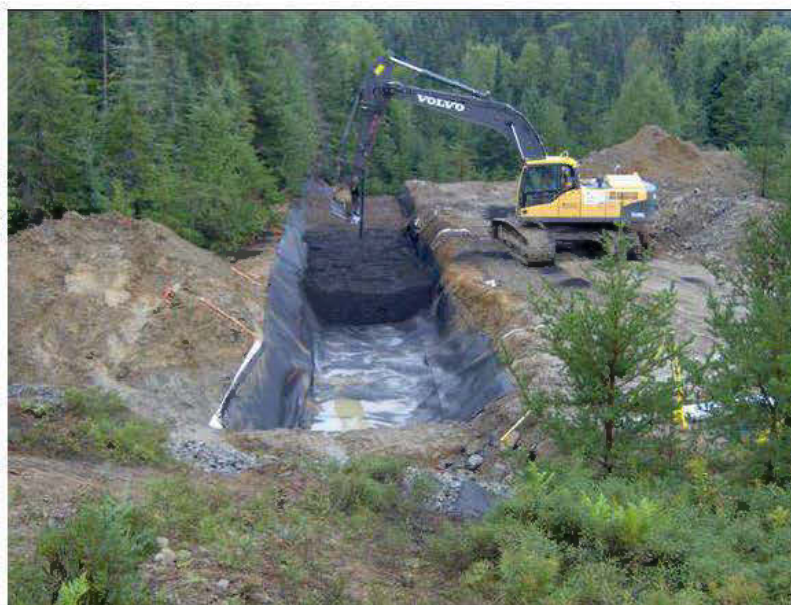
Figure 6.12 Dépôt des matériaux dans la filière de traitement
