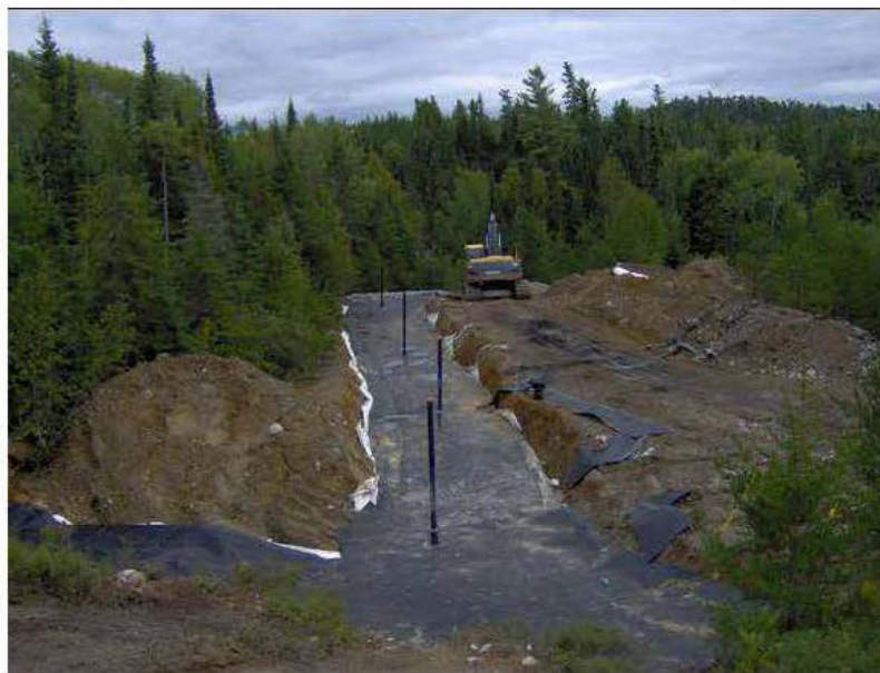
Figure 6.10 Mise en place de la géomembrane supérieure sur le système de traitement et le drain de collecte du DMA
