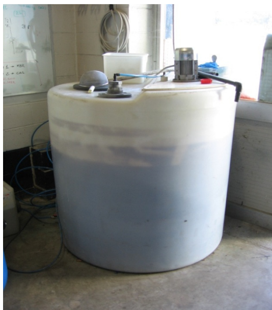
Contenitore utilizzato per l'alimentazione dell'impianto BAG
