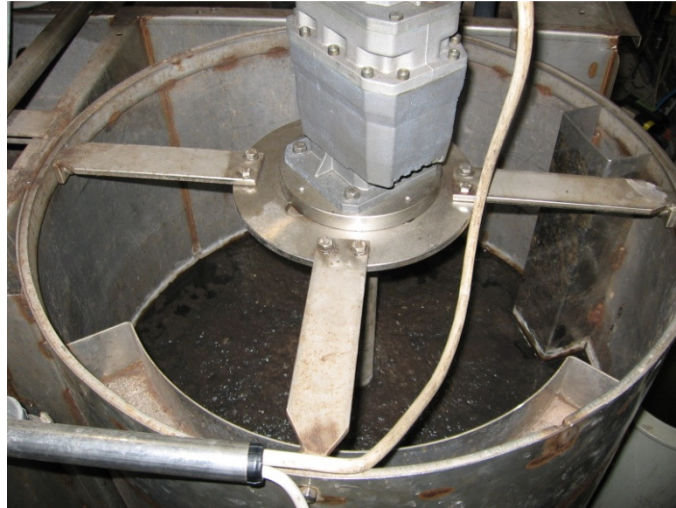
Vasca di sedimentazione dell'impianto CAS
