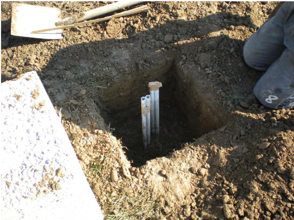
Figura 27. Pozzetto del piezometro Casagrande
