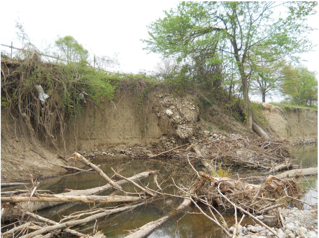
Figura 9. Frana degli argini del torrente Stridolone (GR)
