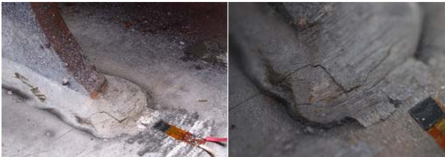
Fig. 7.5 – Viadotto Sesia: vista generale e di dettaglio della lesione per fatica del provino n° 2.
