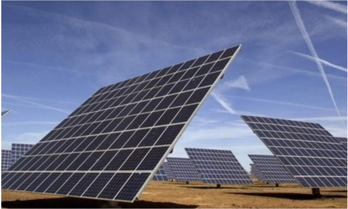
Figura 2.10: Sistema de seguimiento fotovoltaico de la central solar de Amareleja.
