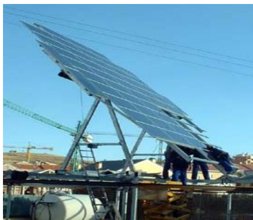
Figura 2.15: Sistema de seguimiento sobre carril. 23
