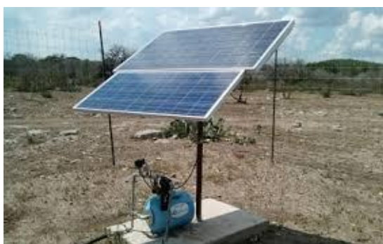
Figura 2.6: Sistema FV autónomo para la extracción de agua. 11
