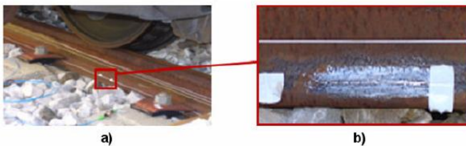
Figura 2.2: Esempio di applicazioni di Fiber Bragg Grating Sensors a un binario ferroviario. Fonte:[11]
