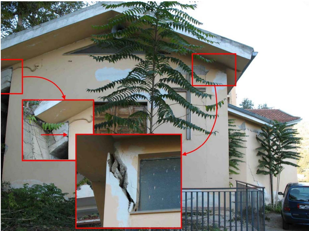
Foto 38: Testata della frana. Lato Sud della chiesa dell'Annunziata. Ad ovest il muro di sostegno di un'altra abitazione che nello scivolamento a valle ha danneggiato la struttura della chiesa (foto Novembre 2006).
