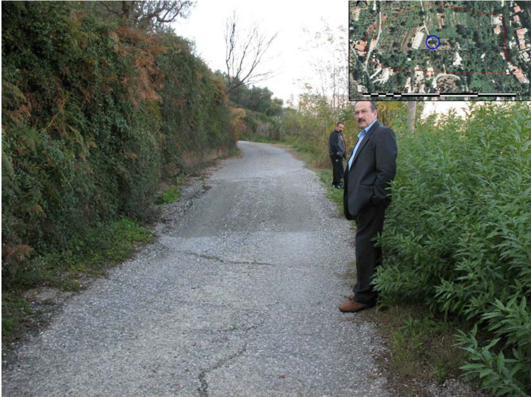
Figura 40: Fenomeni di crepe e cedimenti su strade secondarie.
