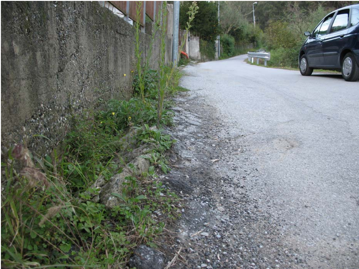
Figura 45: Unghia della frana. Manto stradale deformato in prossimità dei muri perimetrali dei fabbricati 1 e 2.
