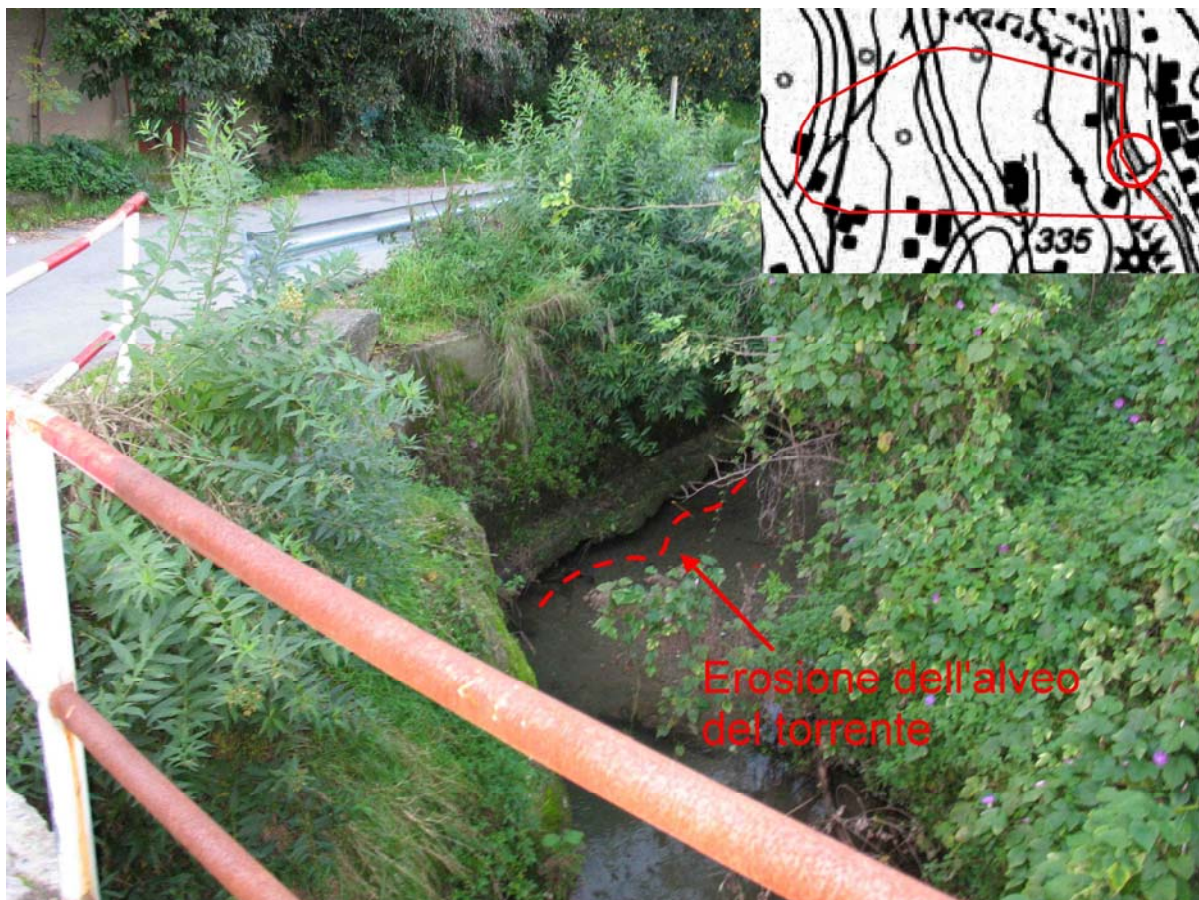
Foto 36: Erosione delle sponde del T. Piazza e scalzamento al piede della frana (Novembre 2006).
