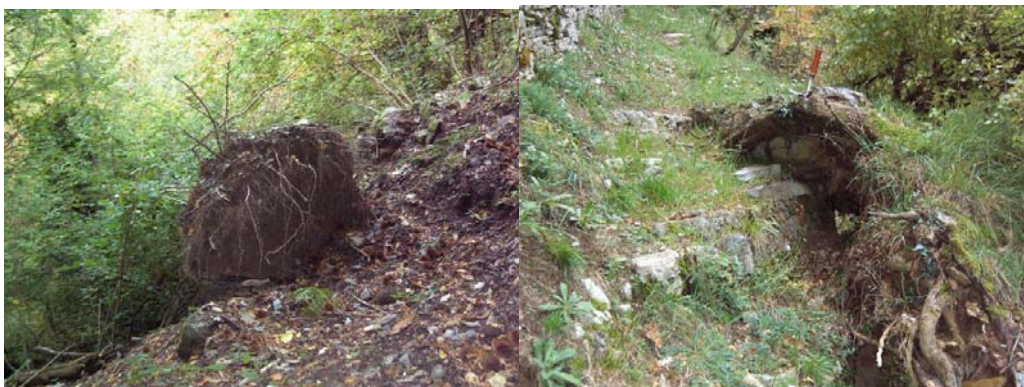
Figura 14-Alberi caduti che destabilizzano il suolo. Nella figura a destra si può osservare come le radici abbiano operato anche nei giunti di discontinuità della roccia.
