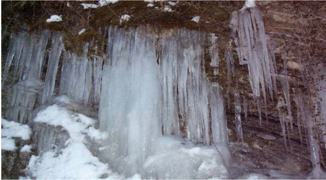
Figura 13-Formazione di ghiaccio nelle fratture durante il periodo invernale. La presenza del ghiaccio interessa anche l'interno dei giunti provocando il fenomeno della gelifrazione. La roccia di questa immagine appartiene alla formazione della Scaglia Toscana.
