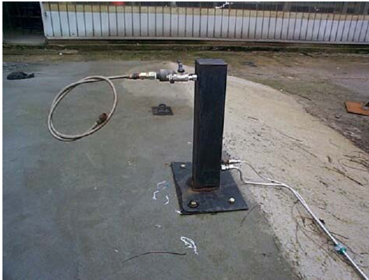
Fig. 2.2.2. – Torretta di interfaccia tra la parte rigida e la parte flessibile della linea d'immissione in CVE
