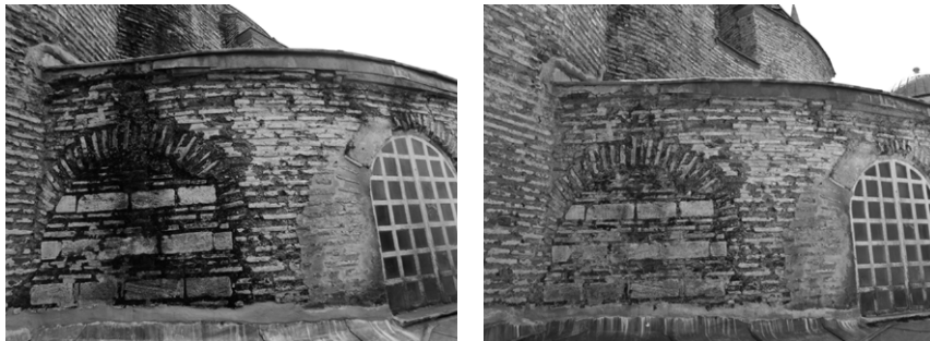
図5 北西エクセドラ外壁の植被(左:2011年2月,右:2012年8月)
