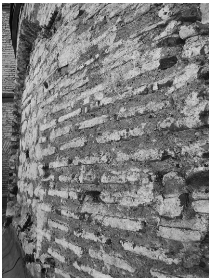
図7 西外壁の風化状況
