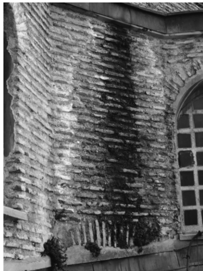
図8 西外壁の植被と雨水の浸入痕
