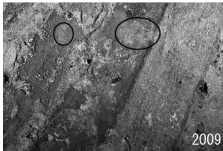
写真12 東壁・女子像 緑衣像 衣および帯（部分） の近接画像。実線で囲んだ部分には乳白色物質が 発生している。
