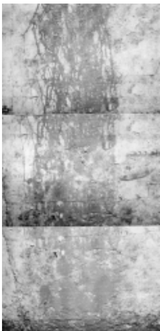
図10. 2001年12月18-21日の点検時に石室内で発生したカビの様子 東壁青龍付近
