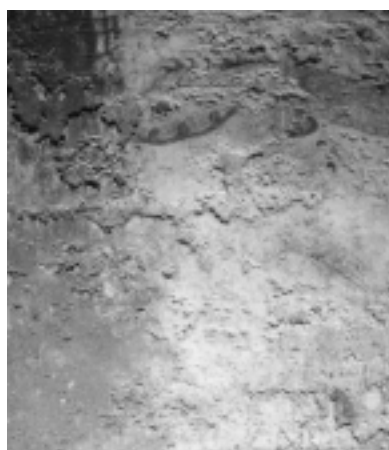
図9. 2001年9月26-28日、東壁、青龍付近の様子 2001年2月の取り合い部の工事-カビ大発生以来、初めて石室を開封したときの様子
