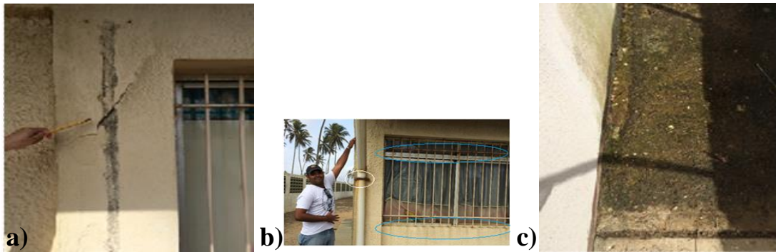
Figura 6. Fallas observadas en el Pre Escolar “A”. a) Mancha y grieta inclinada a 45, b) Sangrado de la rejilla metálica, c) Mancha verduzca en la columna. Fuente: los autores
