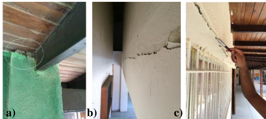
Figura 9. Fallas observadas en el Pre Escolar “B”. a) Desprendimiento del concreto en el apoyo, b) Grieta Longitudinal en viga, c) Desprendimiento del parcheo en la parte superior de la ventana.
