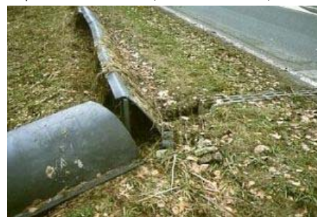
Abb. 2: Defekter Bereich einer ACO-Schutzanlage (L820 bei Siebenstern)
