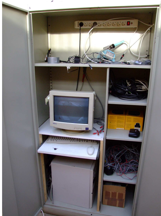
Abb. 3.12: Im Stahlschrank ist der Computer mit der Überwachungssoftware „Iguard“ ausreichend gegen Staub geschützt.
