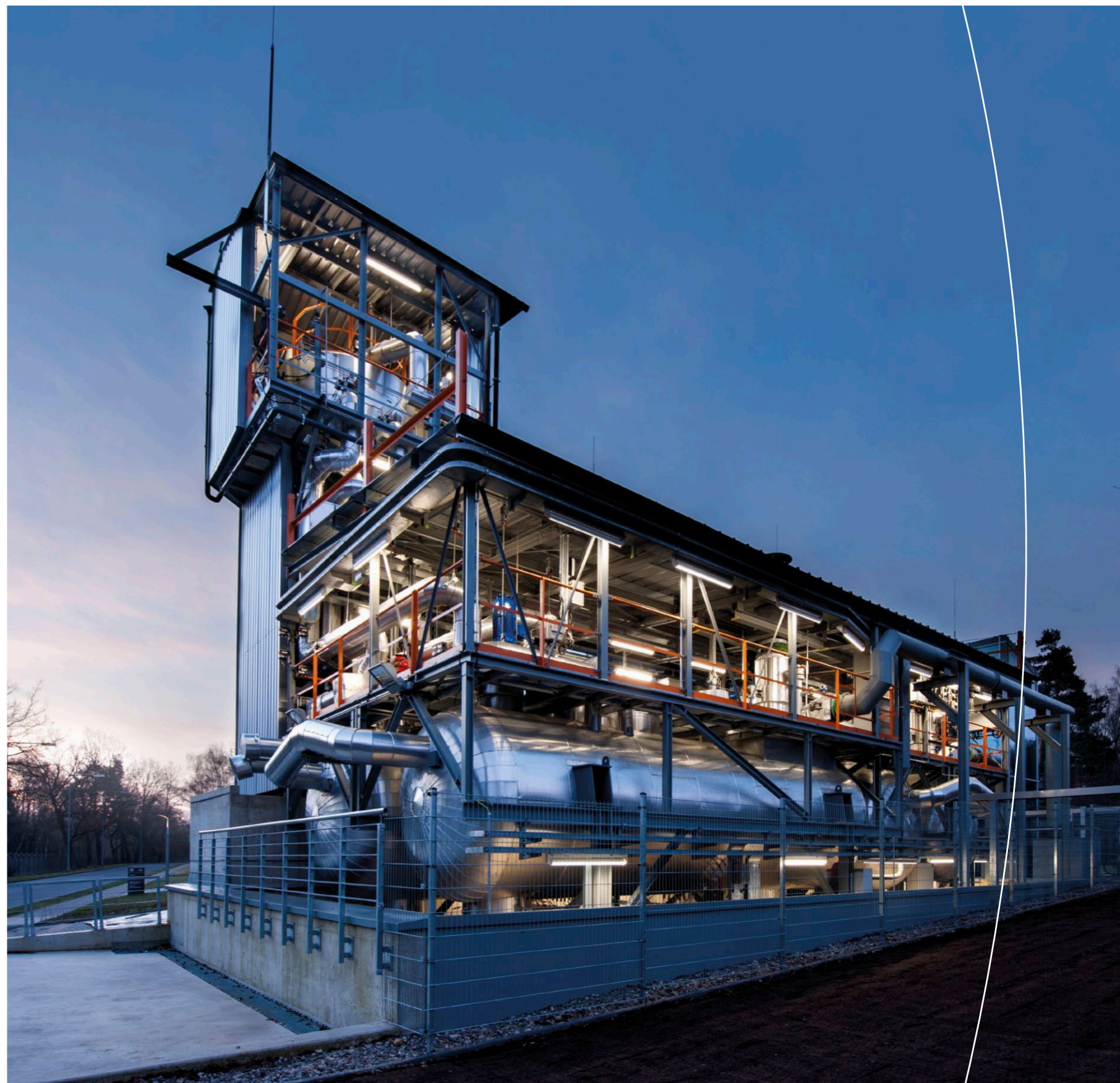
Die weltweit einzigartige Anlage TESIS – Test Facility for Thermal Energy Storage In molten Salt – ermöglicht es der Industrie, Komponenten zur Flüssigsalzspeicherung unter realen Einsatzbedingungen zu testen
