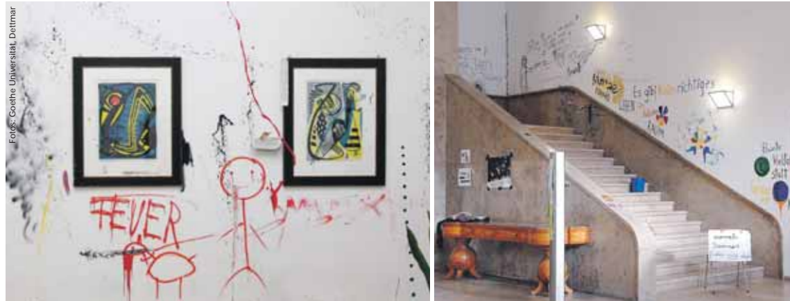
Spuren der Verwüstung im Bereich der Cafeteria (links) und des Treppenhauses (rechts) der Heckgalerie
