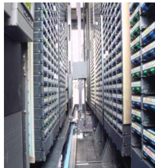
Abb. 2 IBM 3494 Tapelibrary: Blick auf die Kassettenfächer, in der Mitte ist der Greifarm zum Be- und Entladen der Laufwerke zu sehen
