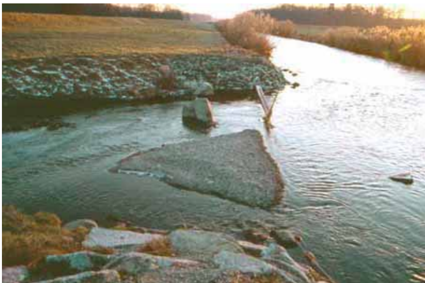
Abb. 3.45: Problem der Verlandung im Einlaufbereich.
