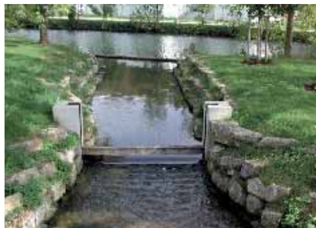
Abb. 3.19 Einlaufbereich eines Umgehungsgewässers mit Dammbalkenverschluss und Schwimmbalken.
