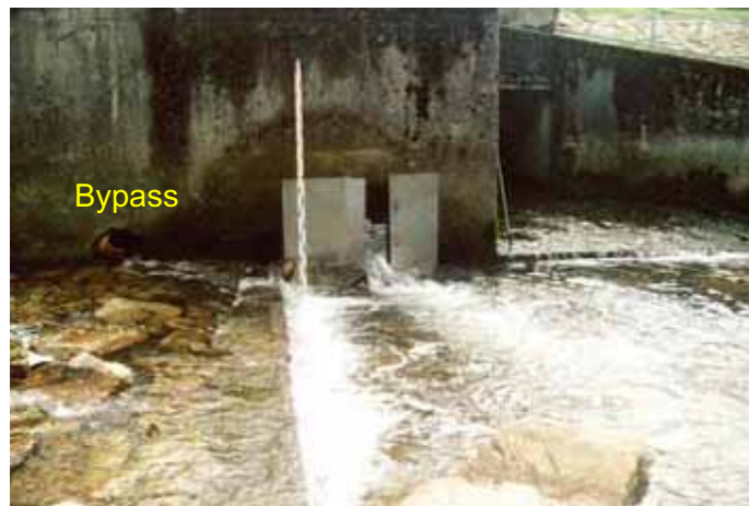
Abb. 4.50: Mündungsblende aus Stahlblech zur Abflusskonzentration unmittelbar unterhalb der Wehrstufe. Links im Bildrand ist die Bypassleitung erkennbar.
