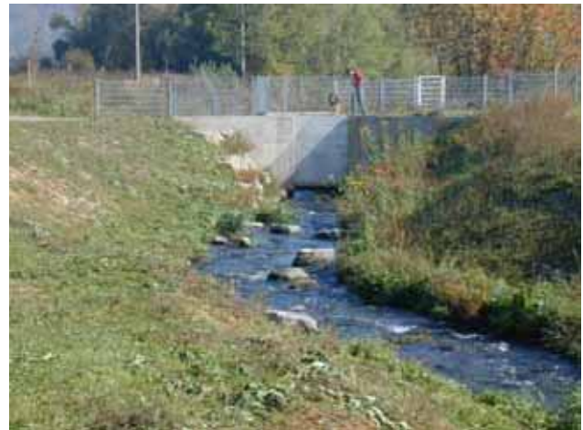
Abb. 4.75: Betriebszustand, Blick Richtung Becken-Schlitz-Pass.
