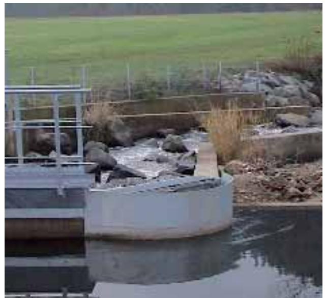
Abb. 3.16: Tauchwand als Geschwemmselabweiser, WKA Gutach Elz.
