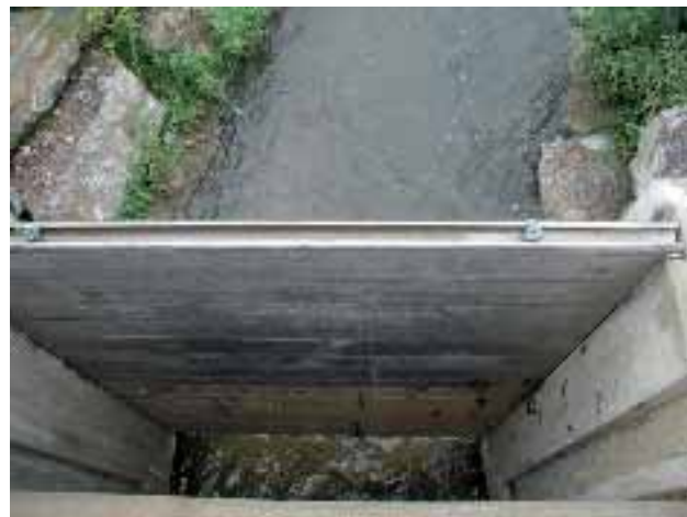
Abb. 3.18: Dammbalkenverschluss zur Abflussbegrenzung bei Hochwasser und Revisionsarbeiten.
