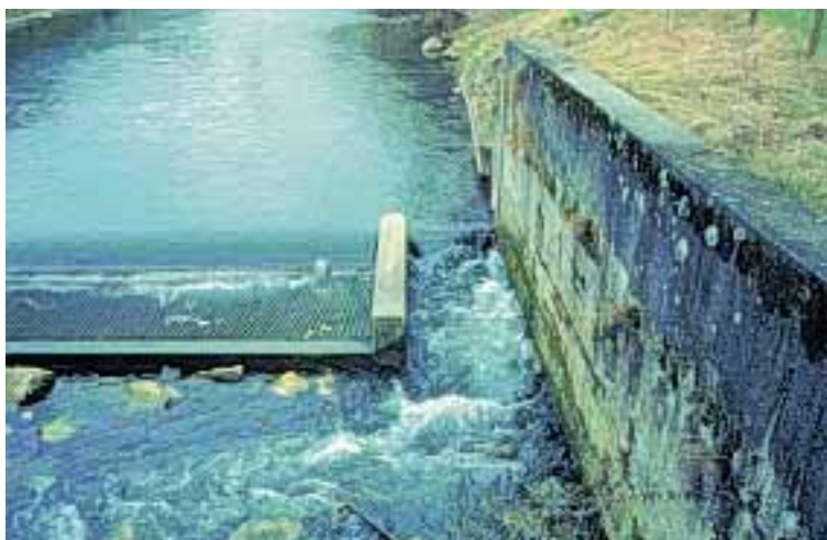
Abb. 2.177: Einlaufbereich mit Mindestwasserabgabe und Tiroler Wehr.
