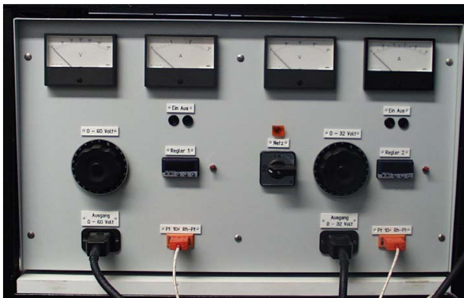
Abb. 36: Netzteil für den Ofen
