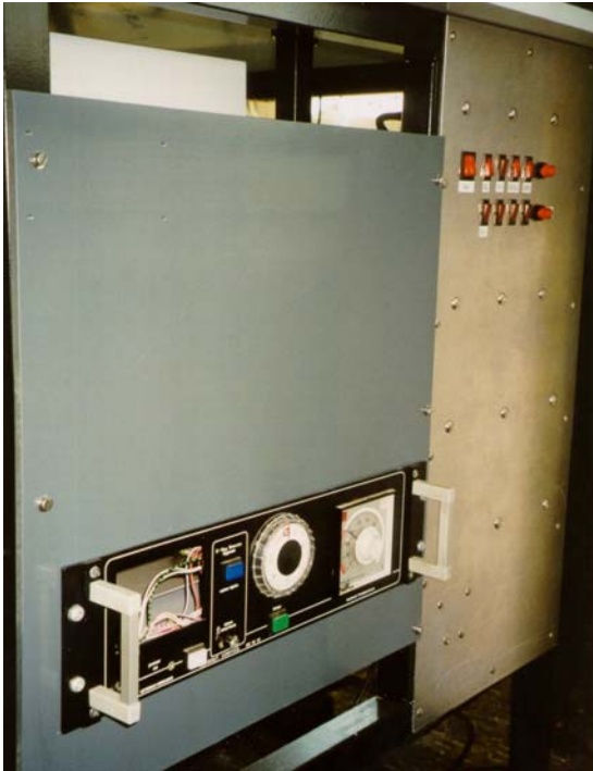
Abb. 37: Schalttableau (re.) und Controller für die Heizmanschetten (li.)
