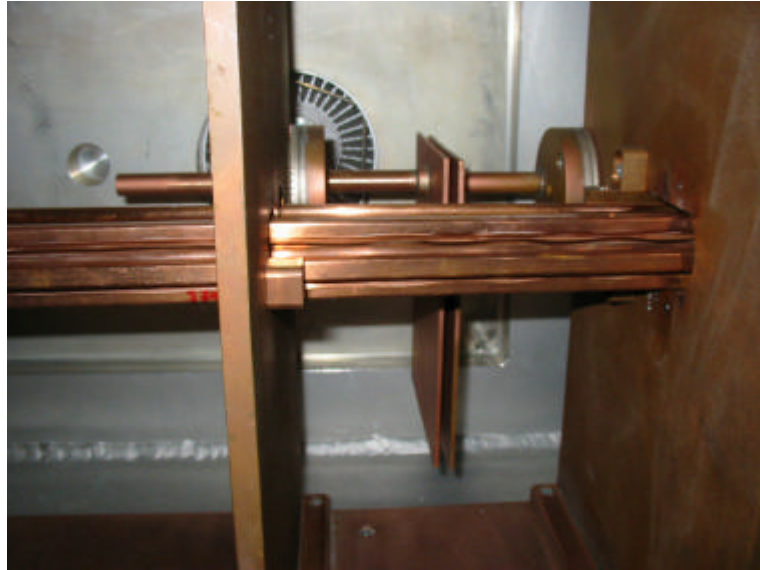
Abb. 6.8: Hinter den Elektroden ist der zusätzliche Kondensator zum Absenken der Resonanzfrequenz eingebaut.
