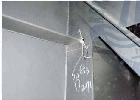
(c) 다이아프램 균열
