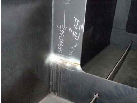
(a) 다이아프램 용접부 균열
