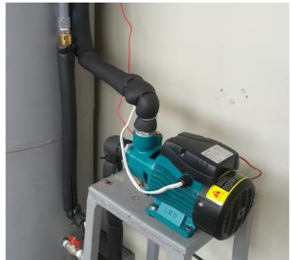
Bomba para recirculación del agua
