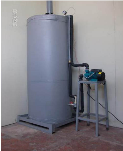
Termotanque conectado al sistema de bombeo de recirculación.
