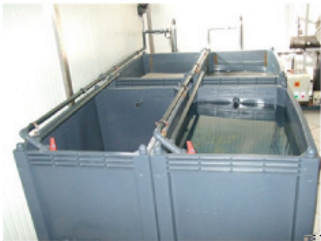
Slika 1. Depuracijski sustav u kojemu dva gornja tanka služe kao mehanički i biološki filter.
