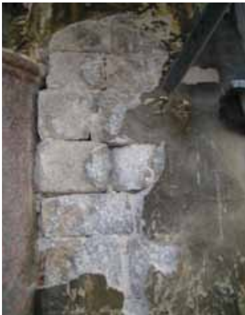
slika 9. Grubo klesani kameni segmenti kojima je ispunjen prostor između dva stupa kolonade
