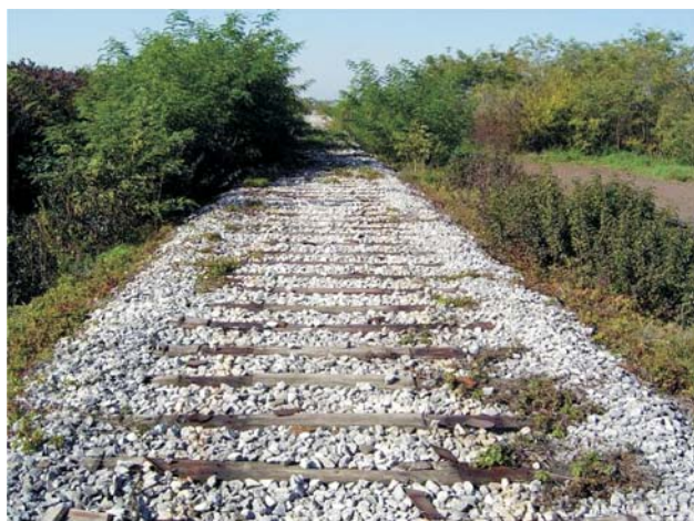
Figure 2 Part of track between Ernestinovo and Laslovo without estranged rails and rail fastening Slika 2. Dio pruge između Ernestinova i Laslova bez otuđenih tračnica i kolosiječnog pribora
