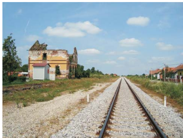
Figure 9 Heavy damaged construction of the train stop in Laslovo/Korođ Slika 9. Teško oštećena zgrada stajališta Laslovo/Korođ
