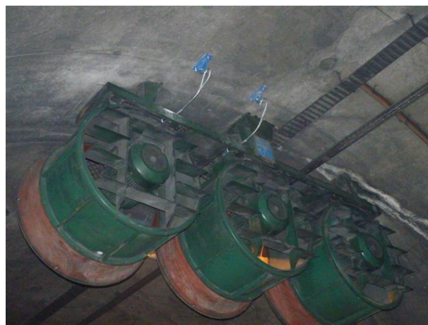
Slika 6. Grupa ventilatora s dodatnim sigurnosnim ovješnjem
