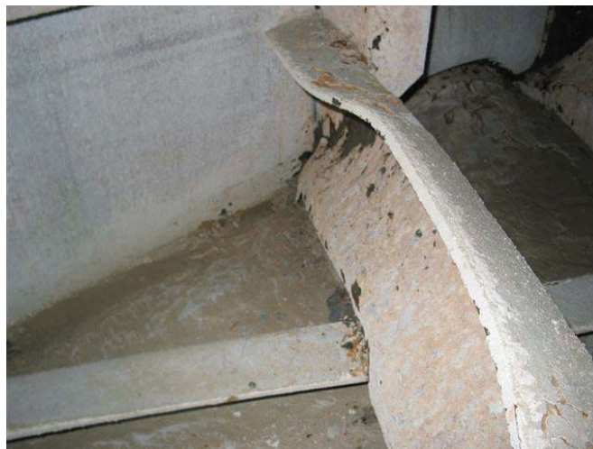
Figure 4 Deformation of transversal and longitudinal girders Slika 4 Deformacija poprečnih i uzdužnih nosača
