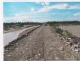
Foto 3. Vista hacia el Norte del terraplén. A la izquierda el canal de riego procedente del río Pescado. A la derecha el río Blanco que después de atravesar el terraplén se curva hacia la margen izquierda.
