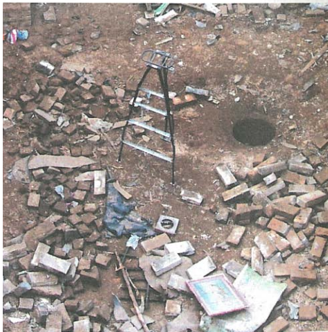
未完工的渗井
