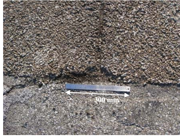
b) Corner spalling
