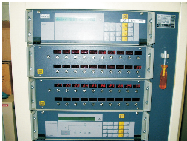
Figure 4 Control unit [6] Slika 4. Upravljačka jedinica ispitne stanice [6]
