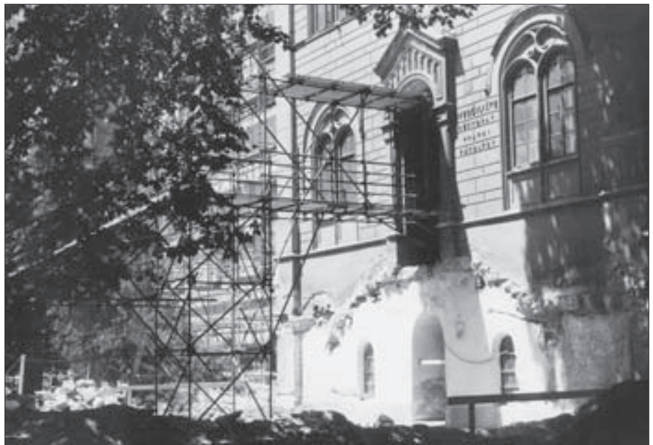
SL. 14. FOTOGRAFIJA ULAZA U ZGRADU ZA RADOVA NA OBNOVI VANJSKOG STUBIŠTA FIG. 14 PHOTOGRAPH OF THE BUILDING ENTRANCE DURING STAIRCASE RESTORATION WORK
