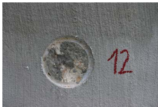
Slika 9. Pull off test – prijelom pretežno u betonskoj podlozi
