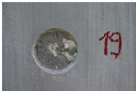
Slika 10. Pull off test – prijelom djelomično u mortu, djelomično u betonskoj podlozi
