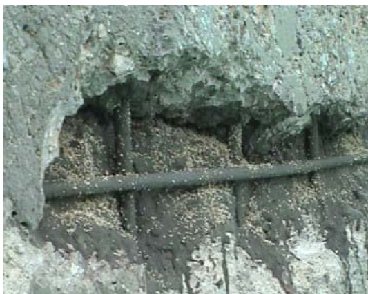
Slika 2. Izvođenje antikorozijske zaštite armature i nanošenje kremenog pijeska za poboljšanje adhezije sanacijskim mortom
