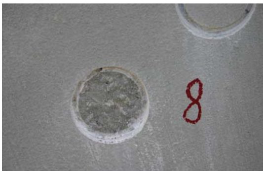
Slika 8. Pull off test – prijelom u mortu
