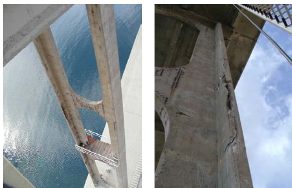
Slika 4. Oštećenja na stupu S21
