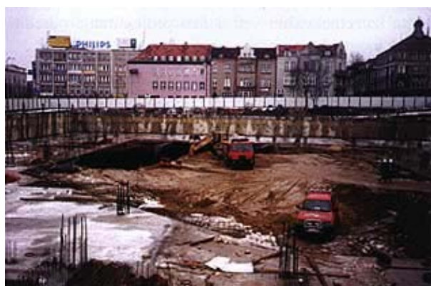
Slika 7. Iskop na razini -1. Podni prsten -1 (ostatak poda izveden je u sljedećoj fazi radova)
