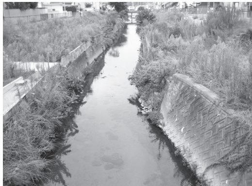
写真2 中橋付近の河道狭窄部 (2010.8.17撮影)
